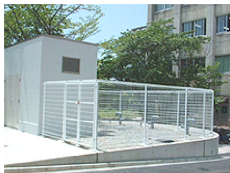
中和・曝気槽
