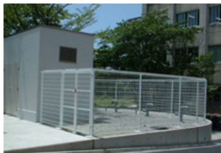
中和・曝気槽
