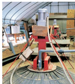
埋設されたバイオガスユニット
