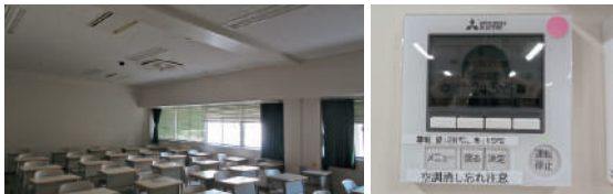
不使用室における退出時の消灯・空調機停止状況調査
